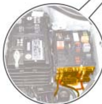
Streifensicherungen an der Sicherungs- und Relaisbox
